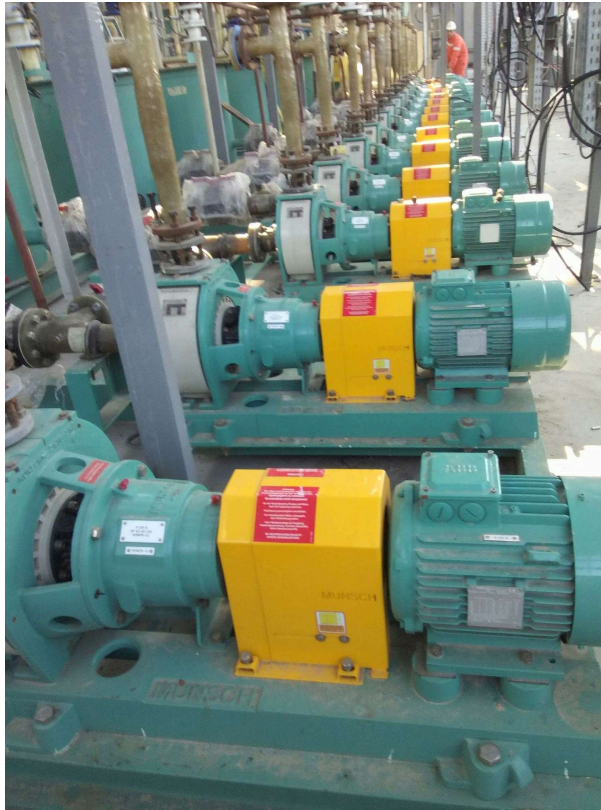
Pumpen als Teil des mechanischen Installationsumfangs von INP für Gips- und Gipskartonwerk. INP Egypt LLC
